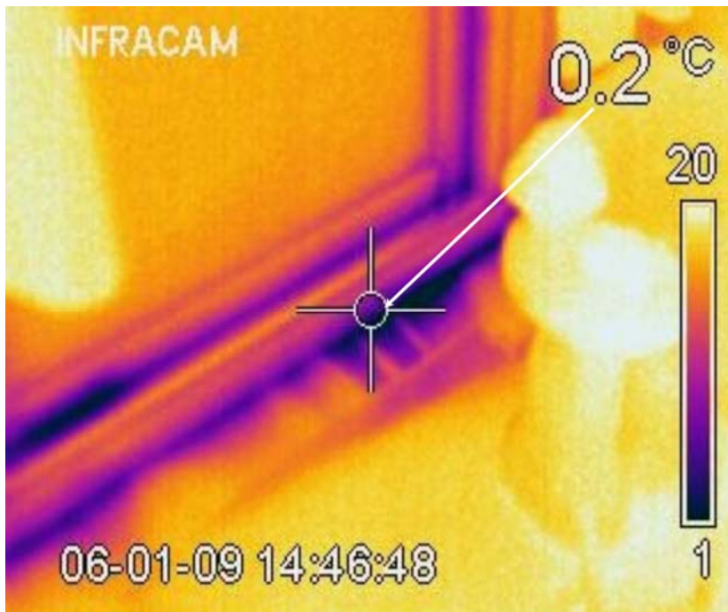
Figur 2.12 Termogram som visar lokal nerkylning av golvet innanför en fönsterdörr.
